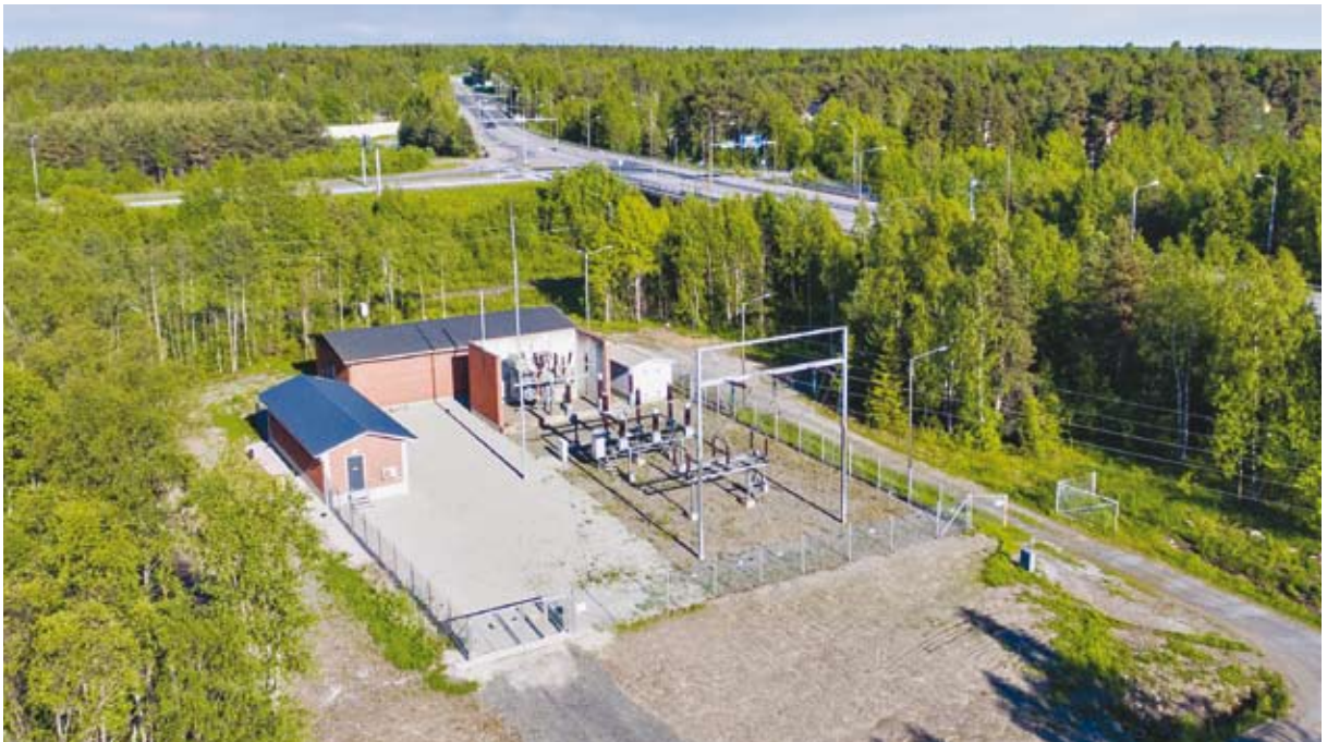
Kemin Energia ja Vesi Oy:n päämuuntajien yhteisteho oli vuonna 2017 75 megavoltiampeeria. Karihaaran muuntamo on 25 MVA.
